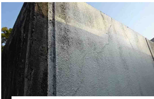
内面の塗装塗膜にも亀裂
