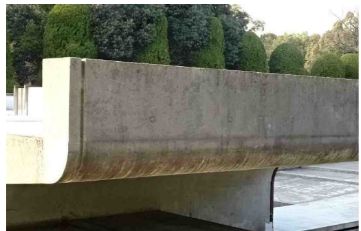
雨水の回り込みで汚れが出ている
