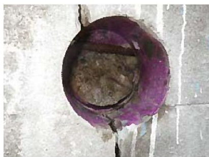
コア抜き内面にフェノールフタレン液をかけた例
