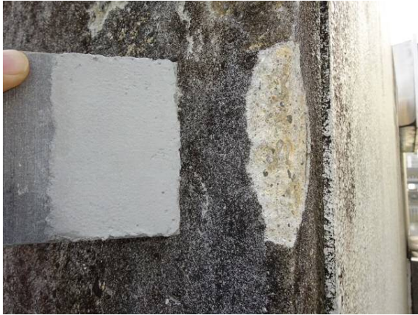
断面修復材との色調比較(北面東柱)
