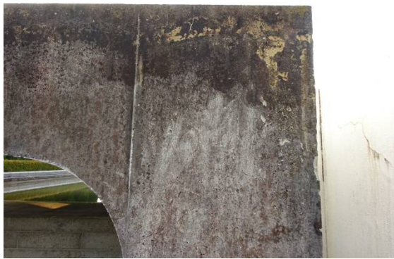
北面東柱(上部) 汚れがひどい
