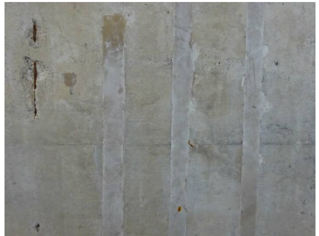
西下面(拡大) ひび割れ補修跡が目立つ
