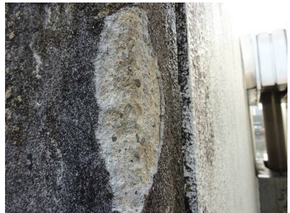
北面東柱(部分剥落箇所)
