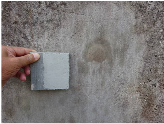
断面修復材との色調比較(北面東柱)
