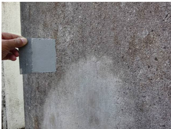
断面修復材との色調比較(北面西柱)
