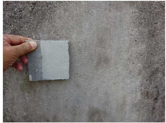
断面修復材との色調比較(北面西柱)
