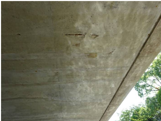
西下面 腐食鉄筋露出がある
