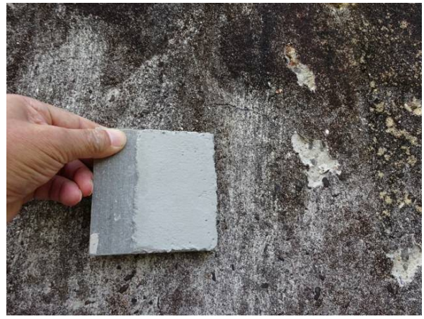
断面修復材との色調比較(北面東柱)
