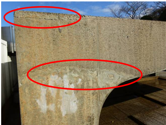
コールドジョイント・打継線(南面)
