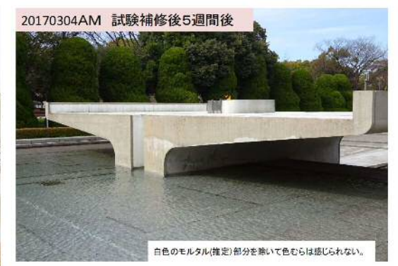
試験補修後5週間 (洗浄後38日後)
