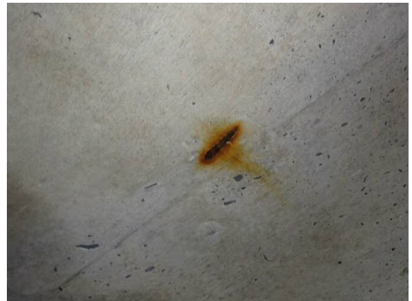
かぶりのない鉄筋露出は防錆後ボカシ剤処理
