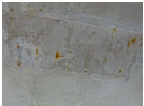
補修部位のひび割れ、錆汁(西壁面)
