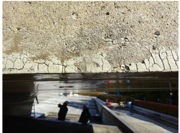
モルタル(補修部位?)の変色・劣化(南面)
