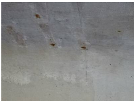
錆汁箇所は状況で防錆後ボカシ剤処理
