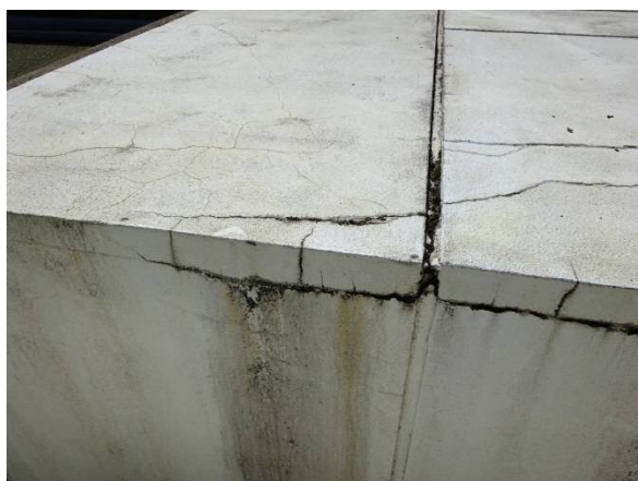
上面のモルタルの割れ・浮きは今回は補修しない
