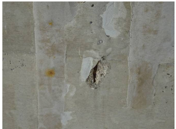
鉄筋露出(下面)
