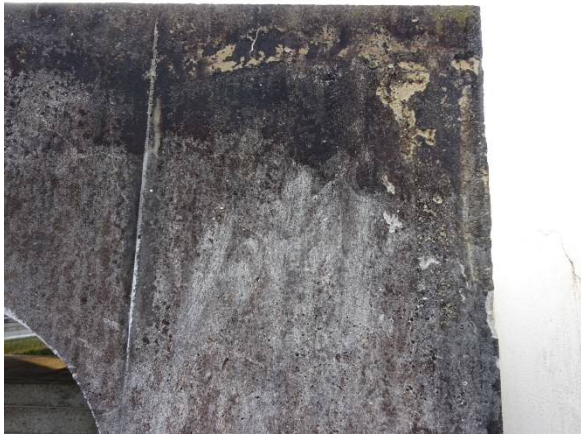
コンクリート面の汚れ(北面)
