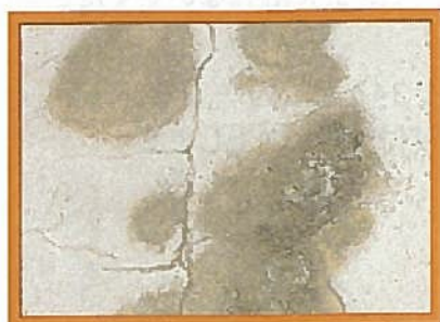
気になるコンクリート面の色ムラ
