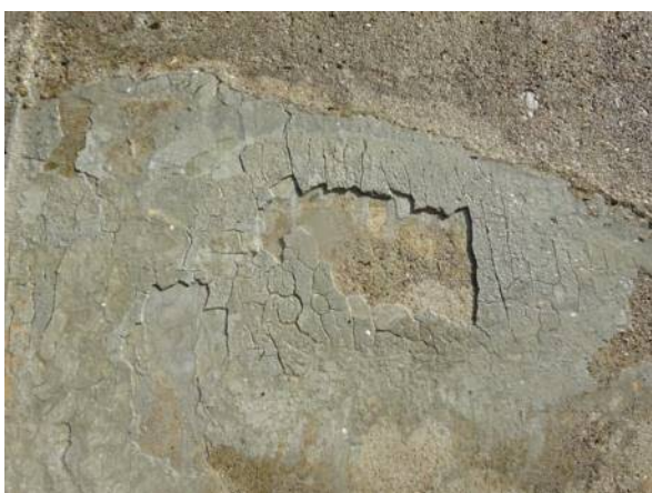
南面: 打継ぎ線の周辺白色モルタル
