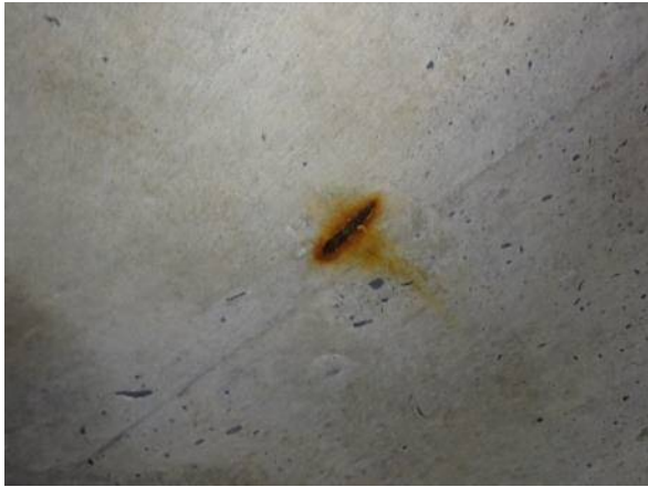
東下面:かぶりのない鉄筋露出
