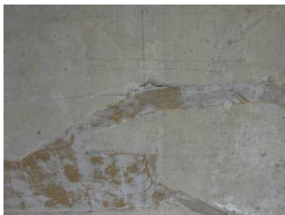
東下面:既補修部の浮き
