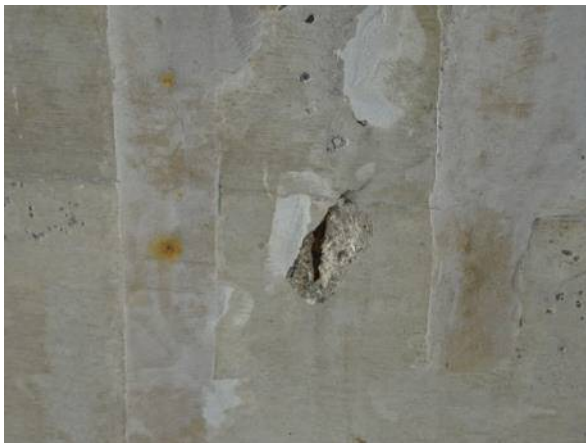
西下面:鉄筋露出
