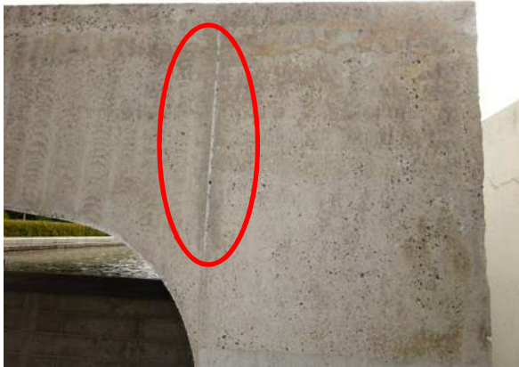
型枠目地部の段差
