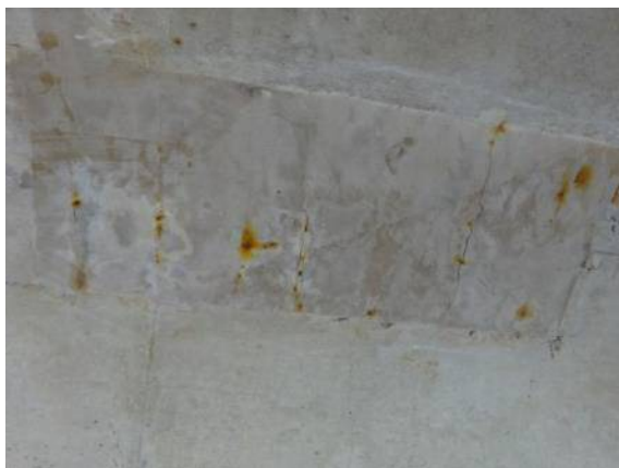
西下面:既補修部のひび割れ、錆汁
