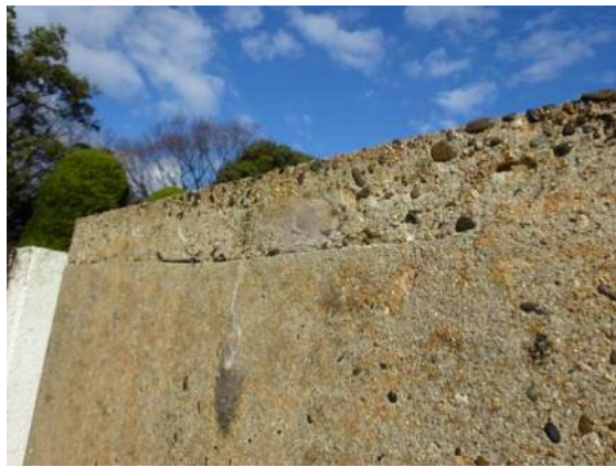
南面:コールドジョイント
