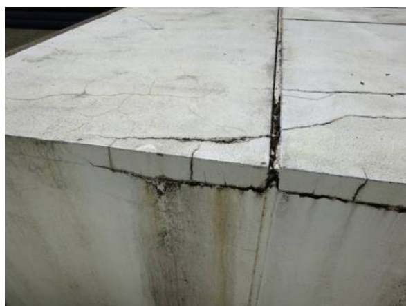
上面のモルタルの割れ・浮き
