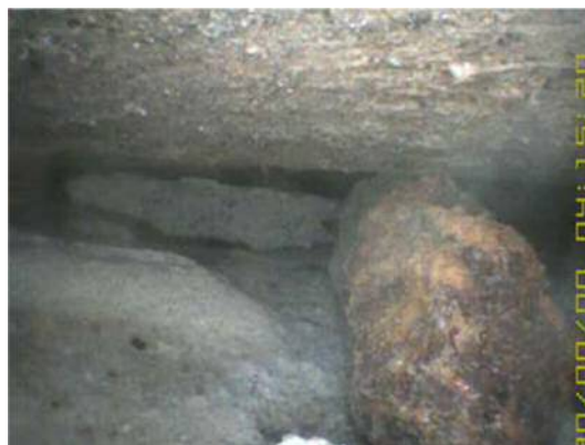
内部空洞に露出する鉄筋、上面はボイドの木枠
