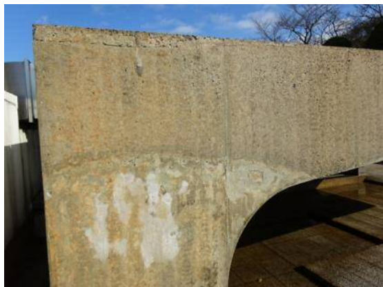
南面: 打継ぎ線の周辺白色モルタル
