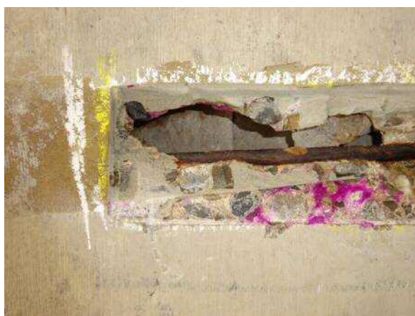
鉄筋背面の空洞とボイドの木枠
