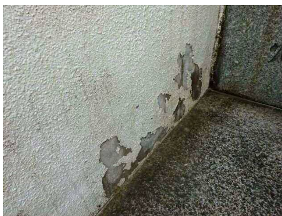
中間面北東側の塗膜剥がれ 損傷程度:b
