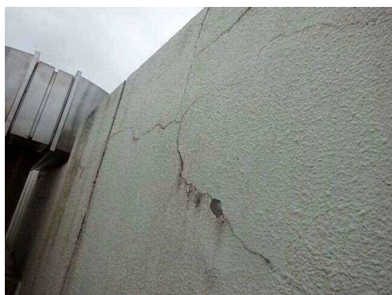
中間面北西側のひび割れ 損傷程度:c
