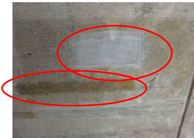
補修箇所の茶色変色と断面修復補修跡
