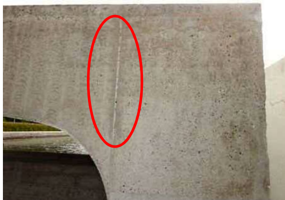
型枠目地部の段差
