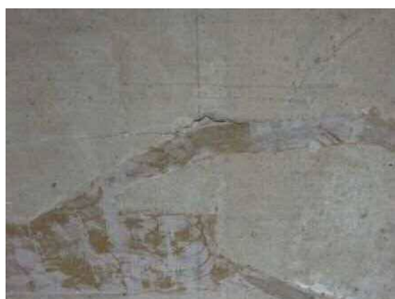
東下面:既補修部の浮き
