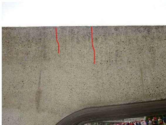
北面西側のひび割れ(開口は残るが補修済) 損傷程度:a
