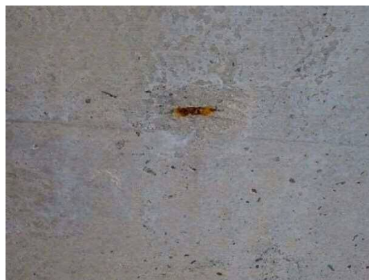
東下面の鉄筋露出(防錆処理済) 損傷程度:d
