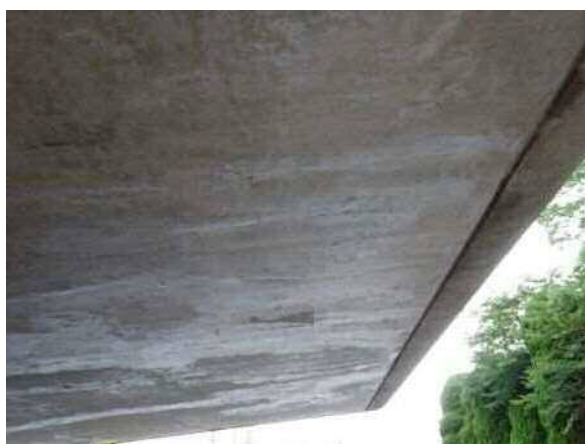
西下面に付着した白い表面含浸材の結晶
