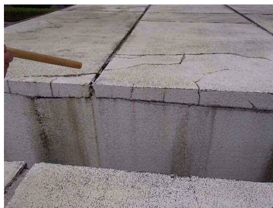
西上面中間面側のひび割れ、浮き 損傷程度:d
