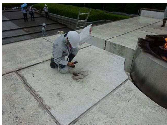
西上面の塗膜剥離と浮き 損傷程度:d
