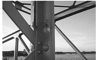
弾丸の貫通したトラス部材
