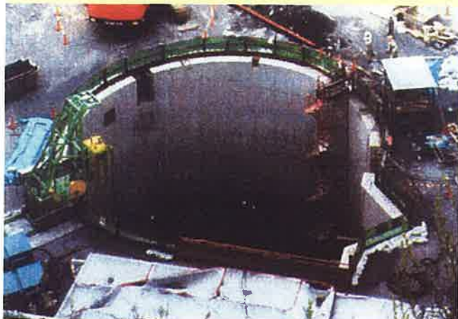
【大規模地下空洞（奥津第二発電所）】
