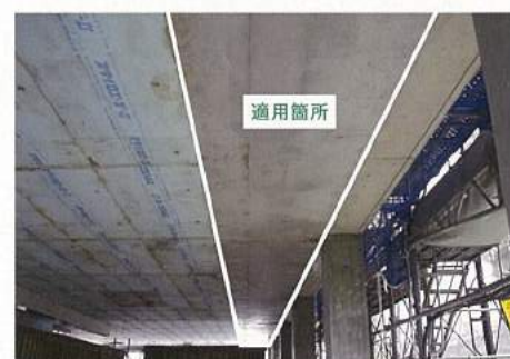
バルコニー天井部
