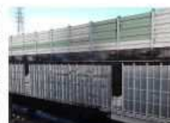
写真5 足場の損傷状況[側面から]
