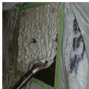
塗装剥離状況
