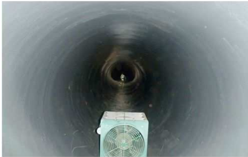
事故が起こった水管橋の内部（写真：愛知県）
