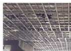
写真4 足場の損傷状況[下面から]
