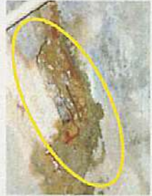
覆工コンクリートの 剥落・貫通ひび割れ
